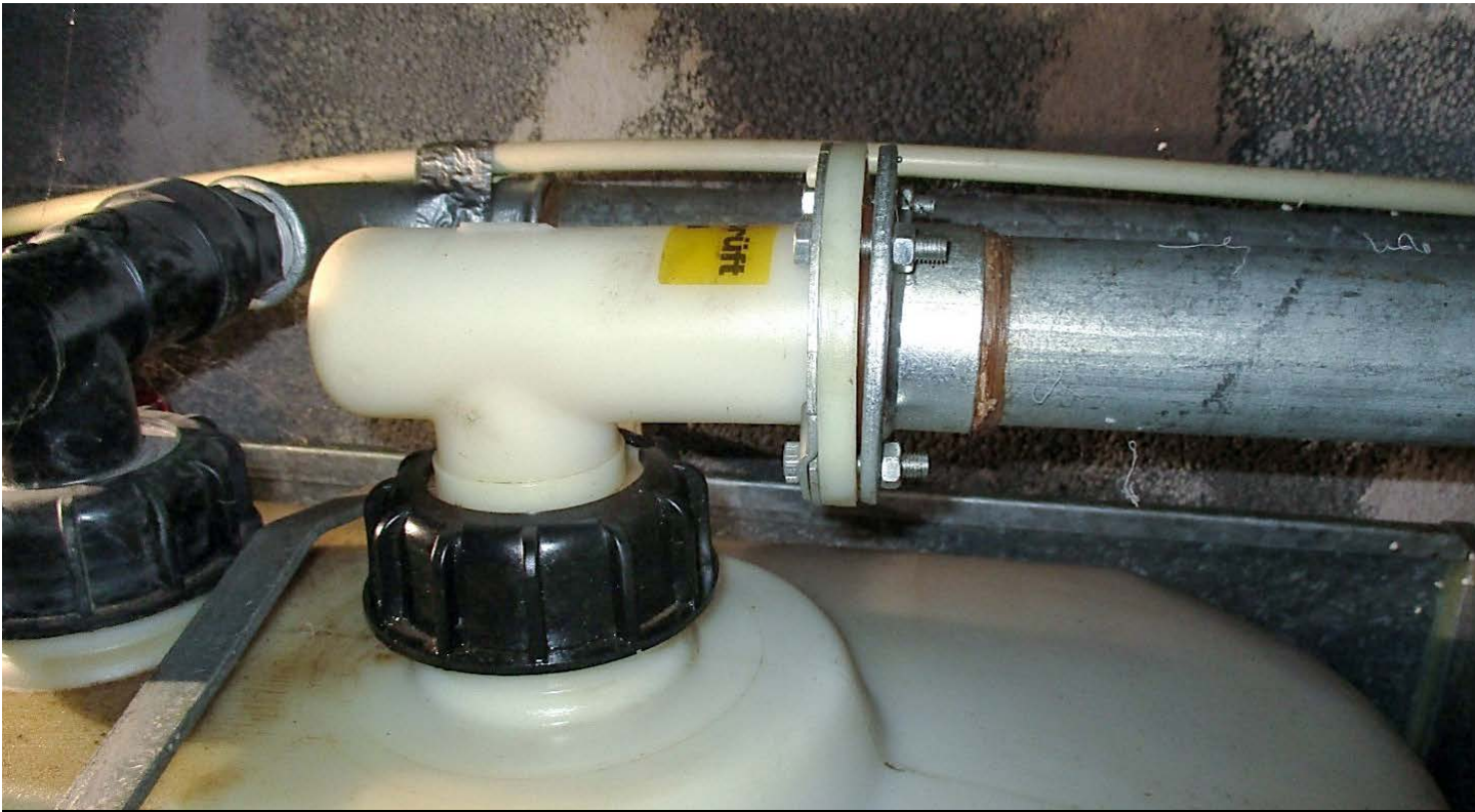
Täyttöputken liitoksessa laipan ruuvien kiristys on käyttövuosien aikana heikentynyt. Liitoksesta on säiliön täytössä tihkunut öljyä. Katselmuksessa huomion kohteena on putkistojen liitosten kunto, ja myös riskejä sisältäviä muutoksia arvioidaan.
