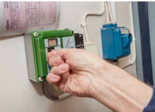
Öljy- ja aurinkolämmityksen tehokkuus syntyy automatiikan kautta.
