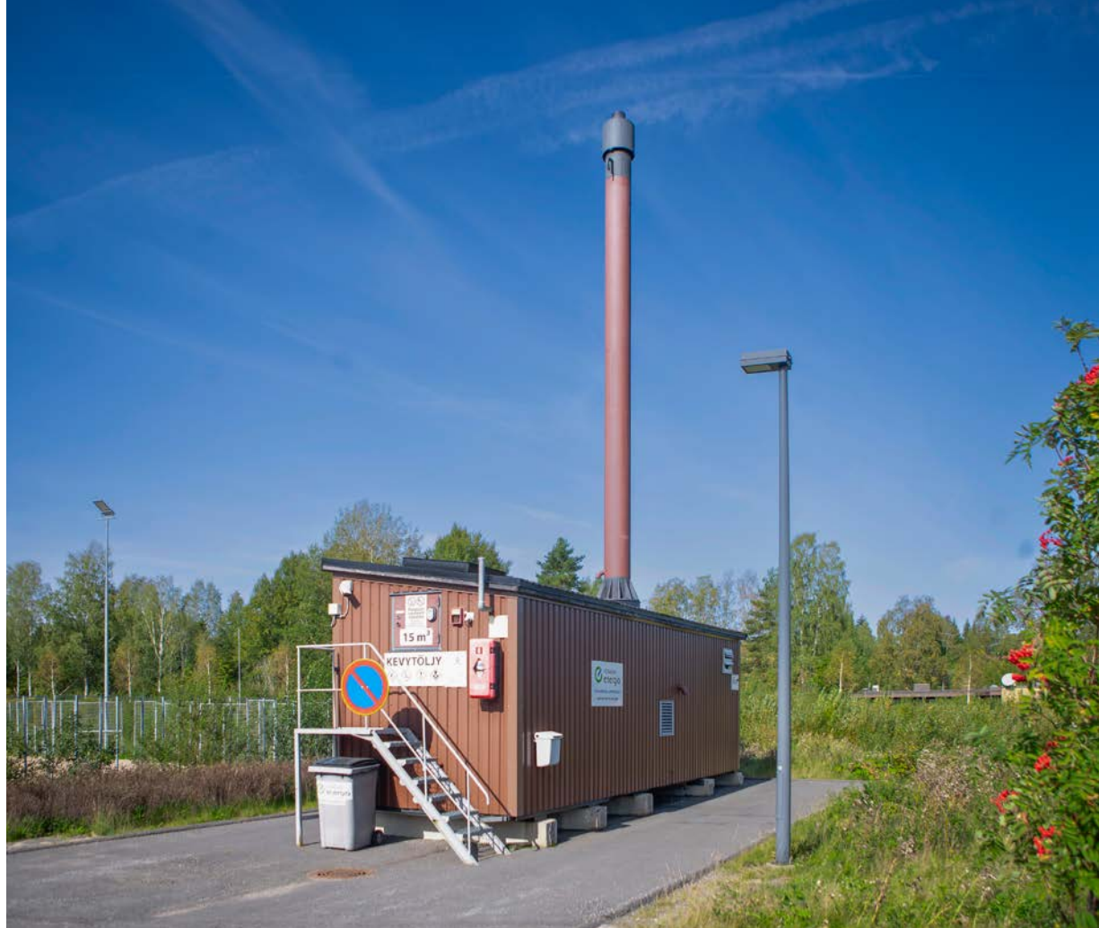
Lämpökontti lämmittää Kerava-Tuusulan paloasemaa. Kontin omistaa ja sitä hallinnoi Keravan Energia. Kontissa on 800 kW:n Viesmannin kattila ja 800 kW:n Oilonin poltin.
