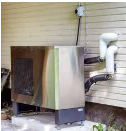
Ilmasta veteen -lämpöpumppu on katoksen alla suojassa lumelta ja sateelta.
