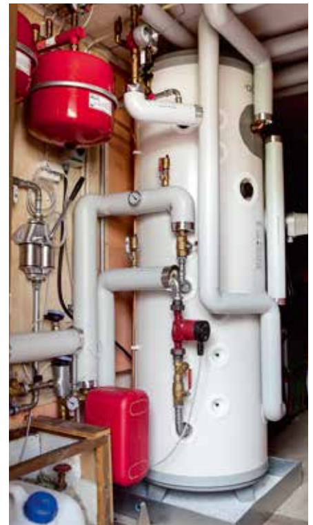
Järeä varaaja hoitaa sekä esi- että jälkilämmityksen.
