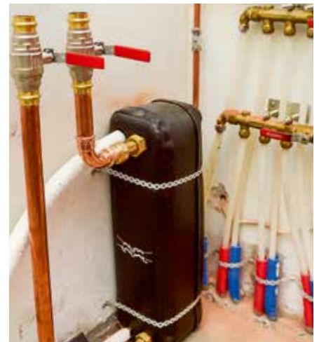
Lämmönvaihdin siirtää ilmasta veteen -lämpöpumpun tuottaman lämmön lämmityspiiriin paluuveteen.
