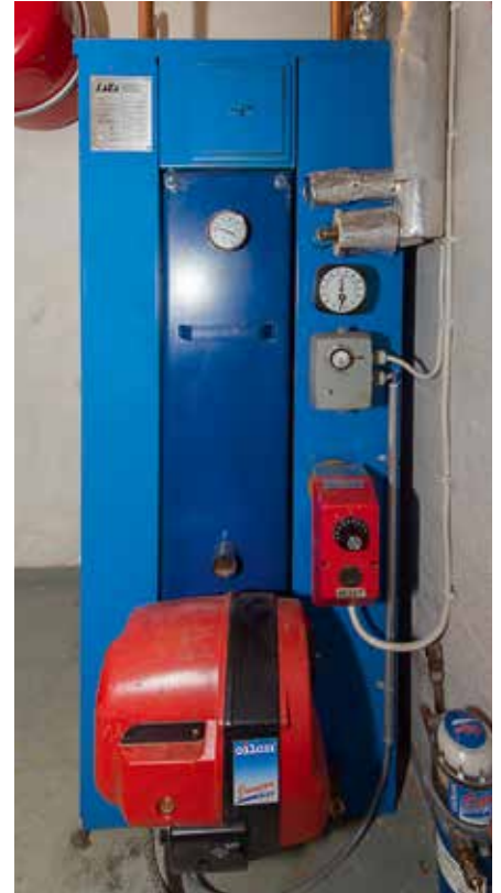
LAKA ZK 10 -kattilassa on muurauksella varustettu vastavirtapolttopesä, joka varmistaa täydellisen palamisen. Oilonin öljypoltin on toiminut moitteettomasti jo 10 vuotta.
