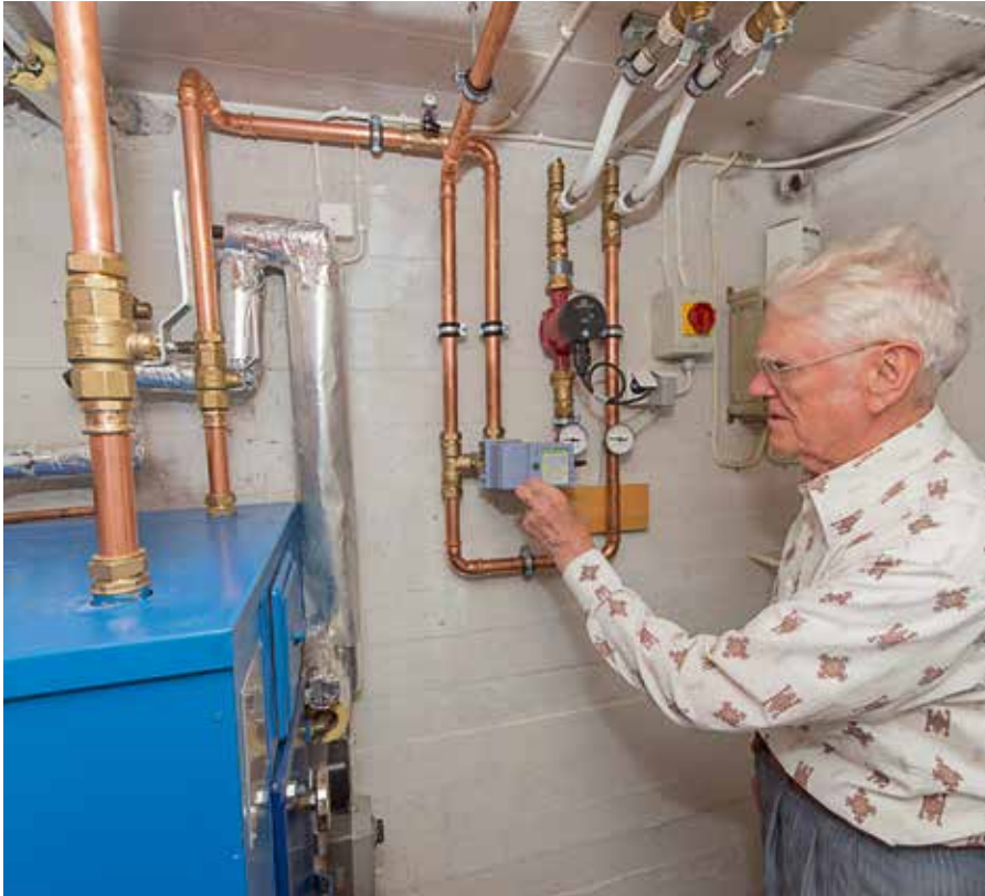
Kun rautaputket vaihdettiin komposiittiin, samalla asennettiin pannuhuoneen putkistoon liittymäventtiilit valmiiksi sekä varattiin tila ilma-vesilämpöpumpuille.
