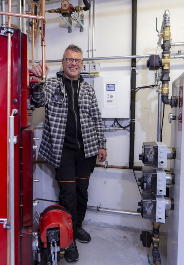
Timo Knaapi on vastannut teollisuushallin öljykattilan huolloista. Knaapi myös asensi öljyn rinnalle otetun ilma-vesilämpöpumpun.
