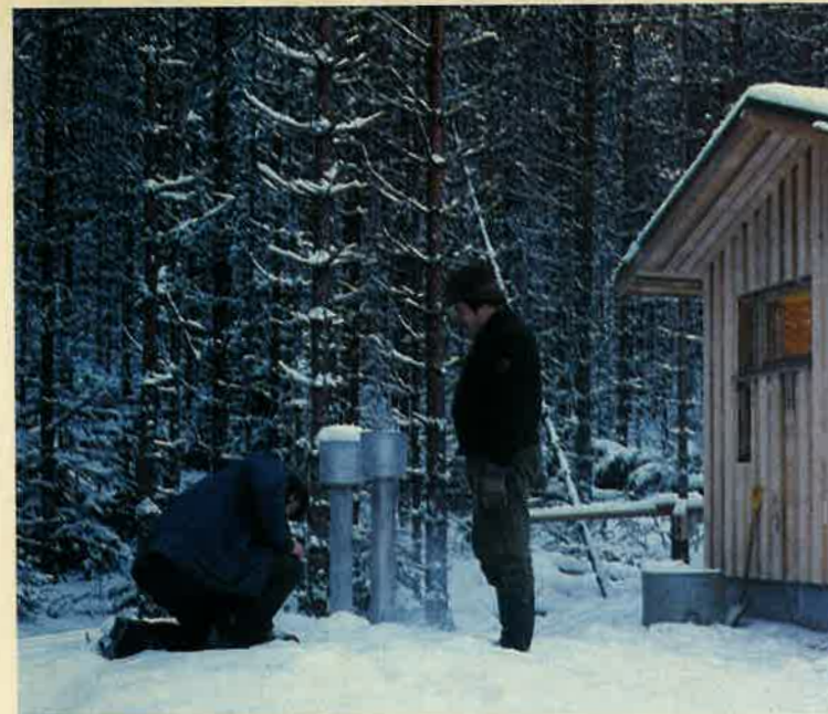
Pumppaamon siiviläputkilokaivo on kahdeksan metriä syvä.
